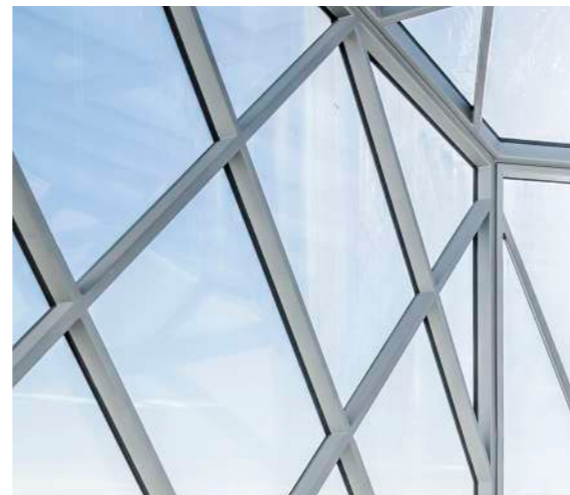
Вид узла изнутри
